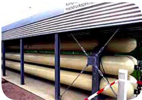
سیستم ذخیره سازی به صورت ایستگاهی در یک جایگاه سوخت گیری
